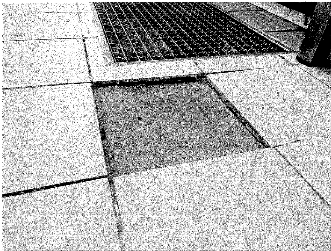
Detail zatečenia – oddelená dlažba a zdegradovaný hydroizolačný náter
