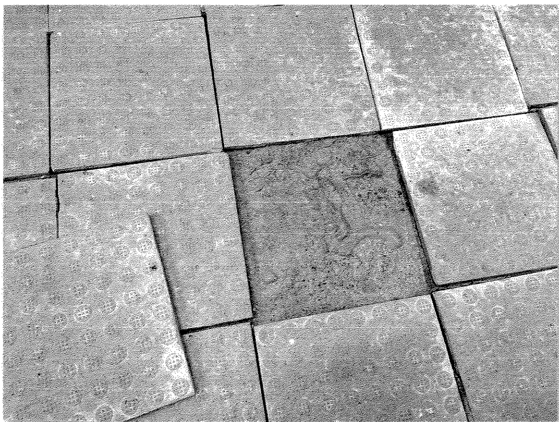
Detail zatečenia – oddelená dlažba a zvyšky zdegradovaného hydroizolačného náteru
